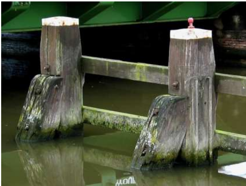
Figuur : geleidewerk bij een brug
